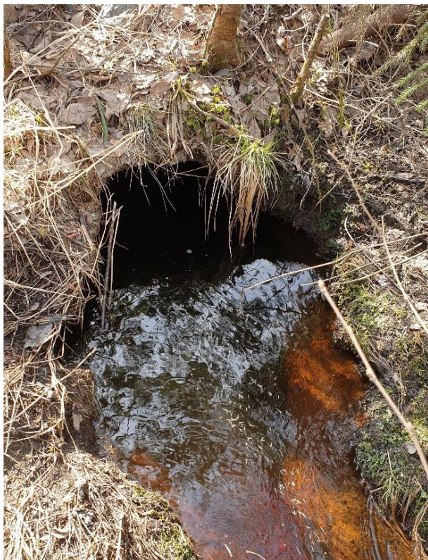
Figur 19. Punkt 1. Trummöga med diameter 800 mm i betong, utlopp vid Krossvägen. Strömmande vatten. Trumma fylld till ca 80%.
