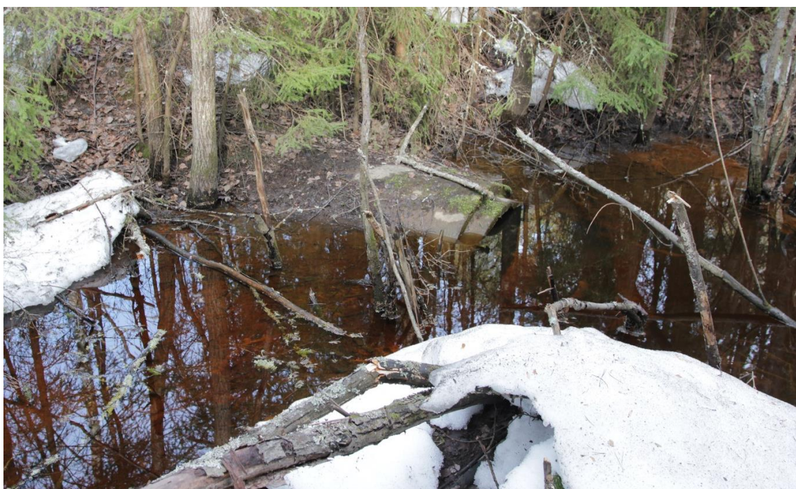
Figur 20. Punkt 2. Utlopp dagvattenledning, 1 000 mm betong vid Kolbäcksvägen. Stillastående vatten. Mottagande dike har högre dikesbotten längre nedströms vilket kan vara en av flera orsaker till dämt utlopp.
