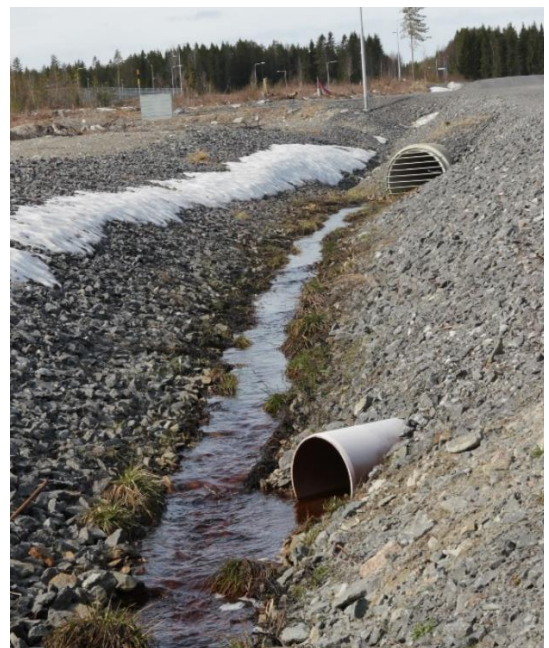
Figur 29. Punkt 10b. Dagvattenutlopp (övre, med galler) och utlopp för pumpstationens nödrädd (nedre). Rinnande dagvatten.
